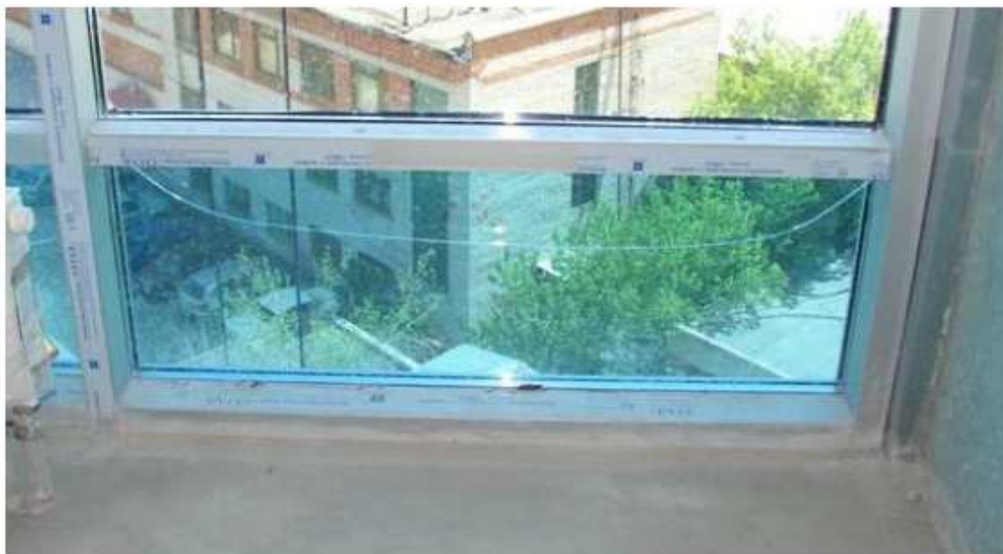
Рис. 3. Пример разрушения стекла в пакете из-за перепада давления и температуры.
