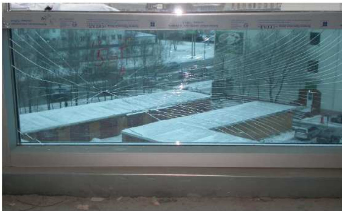
Рис. 4. Пример разрушения стекла в пакете из-за перепада давления и температуры.
